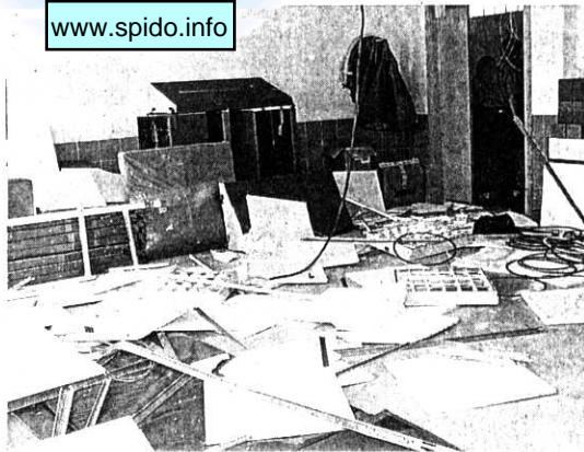
DAÑOS. Los paneles que se desplomaron en el aula. / V. V. / AGM
